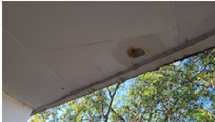
Foto 4. Betonschade in plafond galerijplaat.
