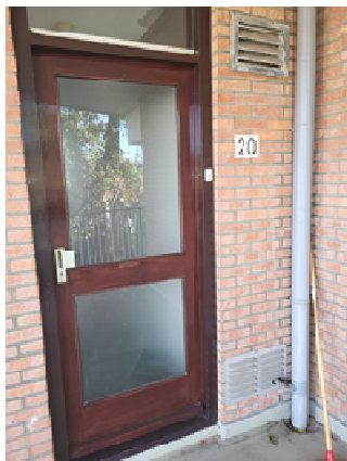
Foto 6. De kozijnen op de 3 e verdieping galerijen zijn in 2021 geschilderd.
