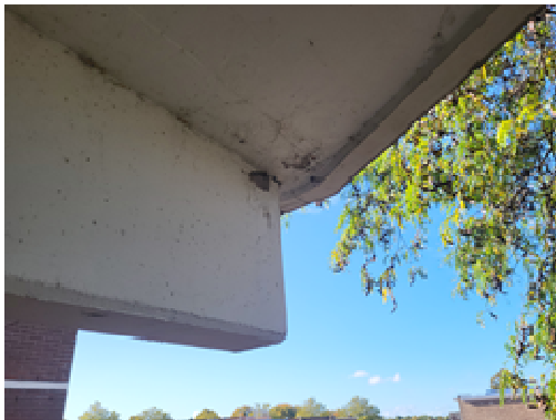
Foto 3. Betonschade aan een console.
