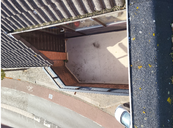
Foto 7. Vervuiling dakgoten (hellende daken voorzijde).
