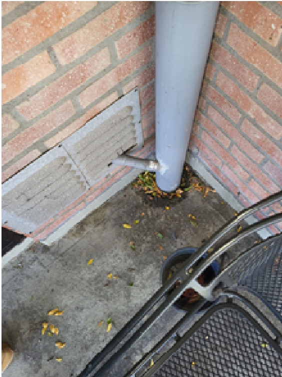
Foto 9. Vervuiling putje hemelwaterafvoersysteem galerijen.
